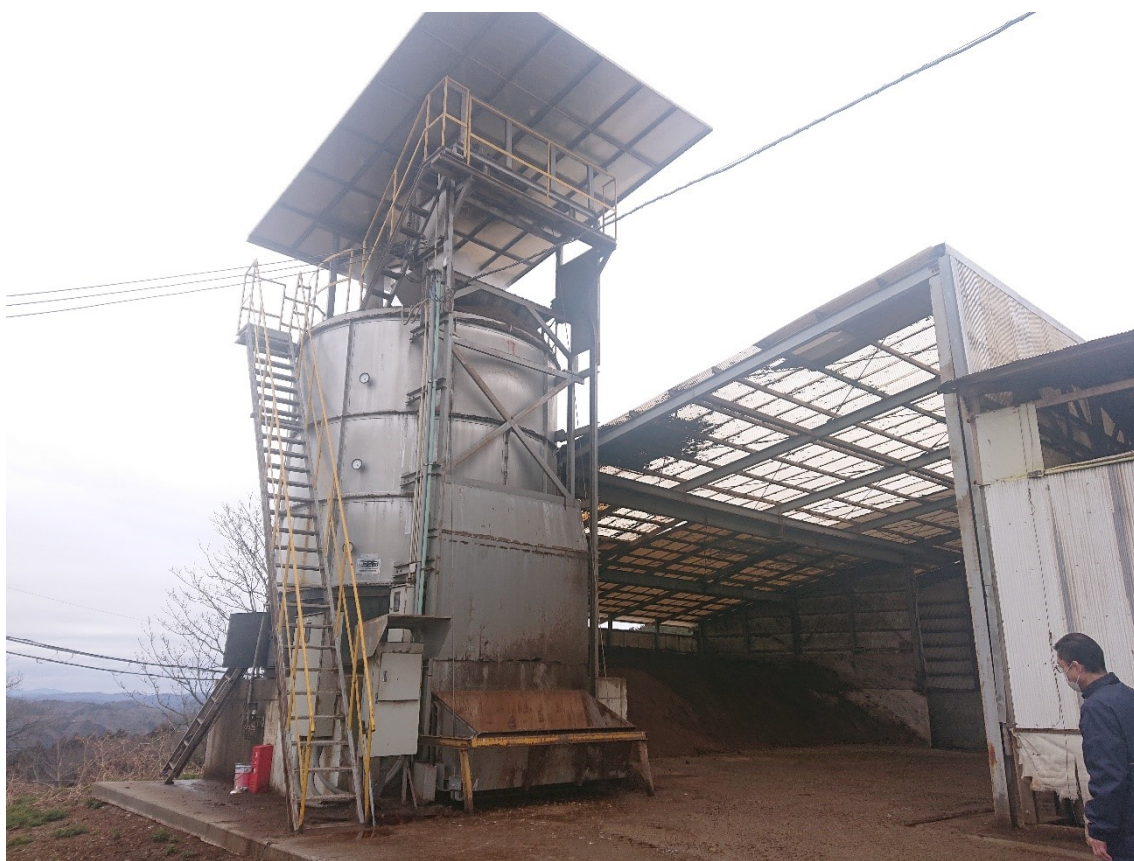
堆肥化处理施設
