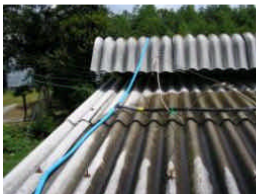
写真2 屋上に設置した散水パイプ
