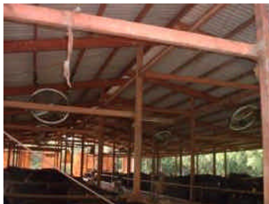
写真1 牛舎に斜めに設置した送風機
