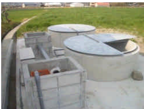
写真1 簡易な尿の曝気処理施設
