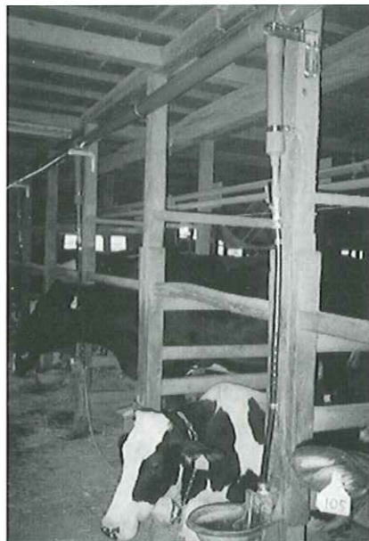
写真2 配管後の牛舎内
