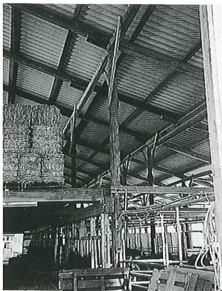
写真：古電柱を利用した柱
