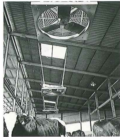
写真：畜舎に取付けられた天井扇
