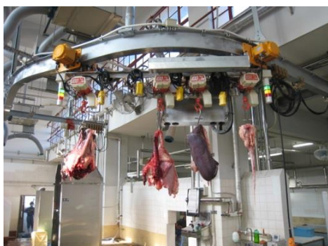
図4 赤物搬送装置(大動物解体室)
