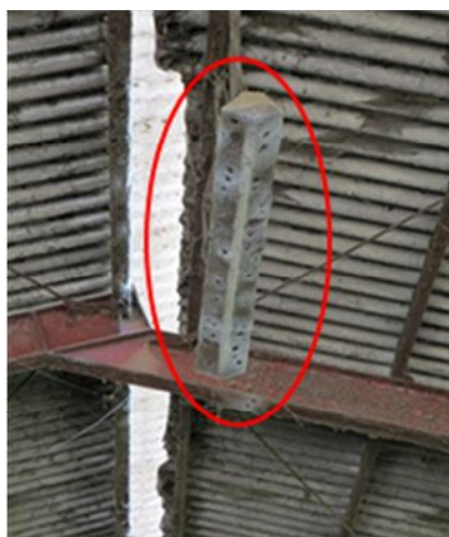
図13 LED設置前の蛍光灯
