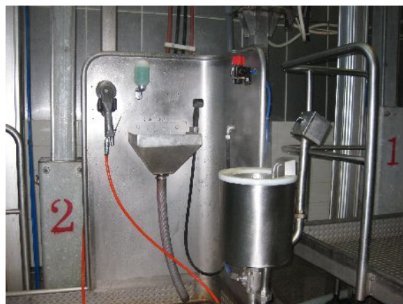
写真4 消毒・洗浄設備
